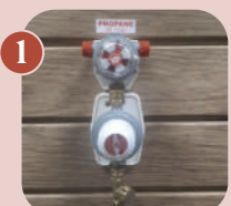
Kit inverseur prêt installé.
