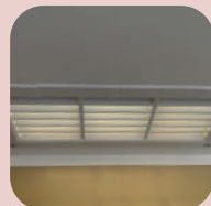
Bouche de ventilation haute
