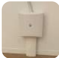
Caja de conexiones
